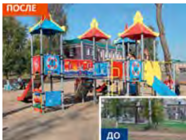
Строительство детской площадки в семейном парке «Радуга» в с. Залесово Залесовского района Алтайского края
