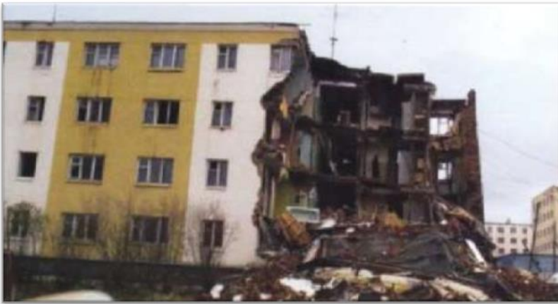
Фото 2. Разрушение домов в зоне оттаявшей вечной мерзлоты в России
